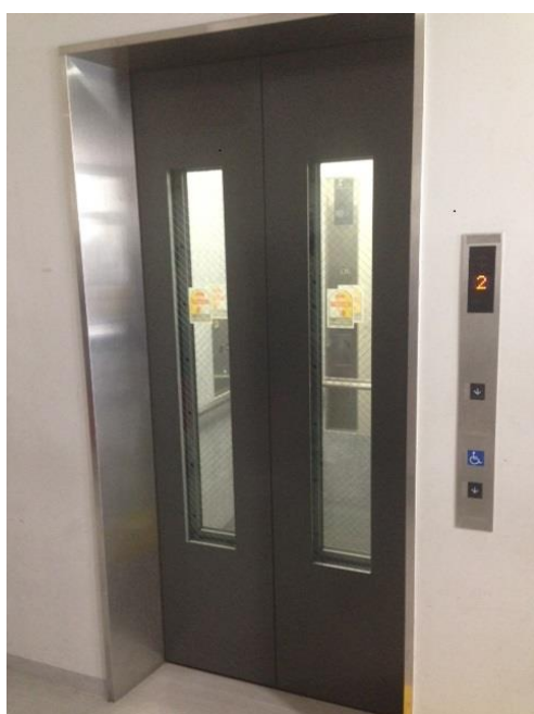
【写真3】 1階のエレベータ
