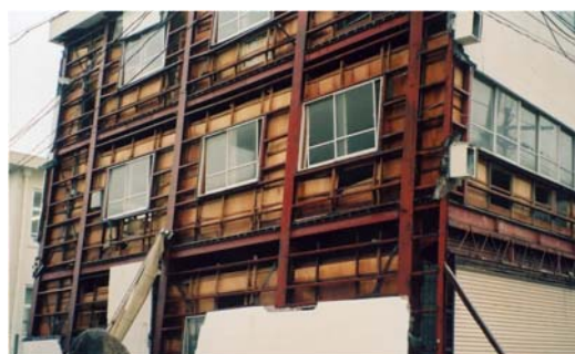
図2 崩落した外装仕上げ材（兵庫県南部地震）
